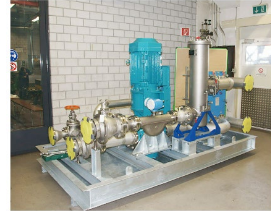
Kontrollstation Konstruktion, Teilefertigung, Montage
